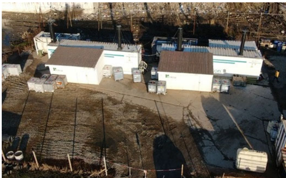
Figura nr. 4-1 Stația de epurare levigat
