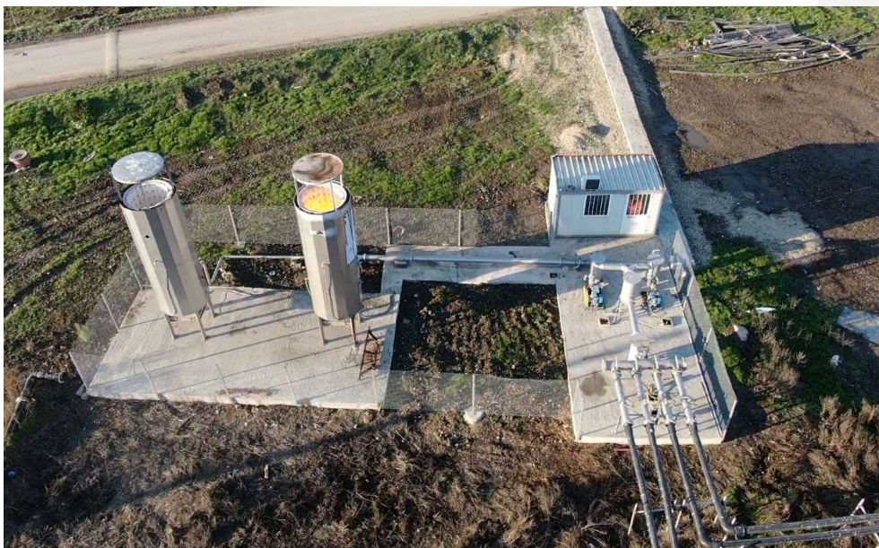
Figura nr. 1.4 Instalație de ardere controlată a gazului de depozit
