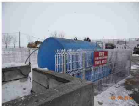
Figura nr. 2-5 Stație de alimentare cu carburanți (dreapta)
