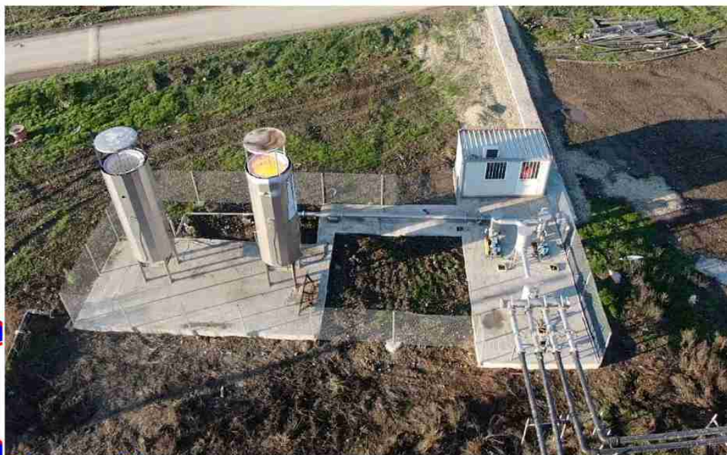
Figura nr. 2-3 -1 Instalație de ardere controlată a gazului de depozit
