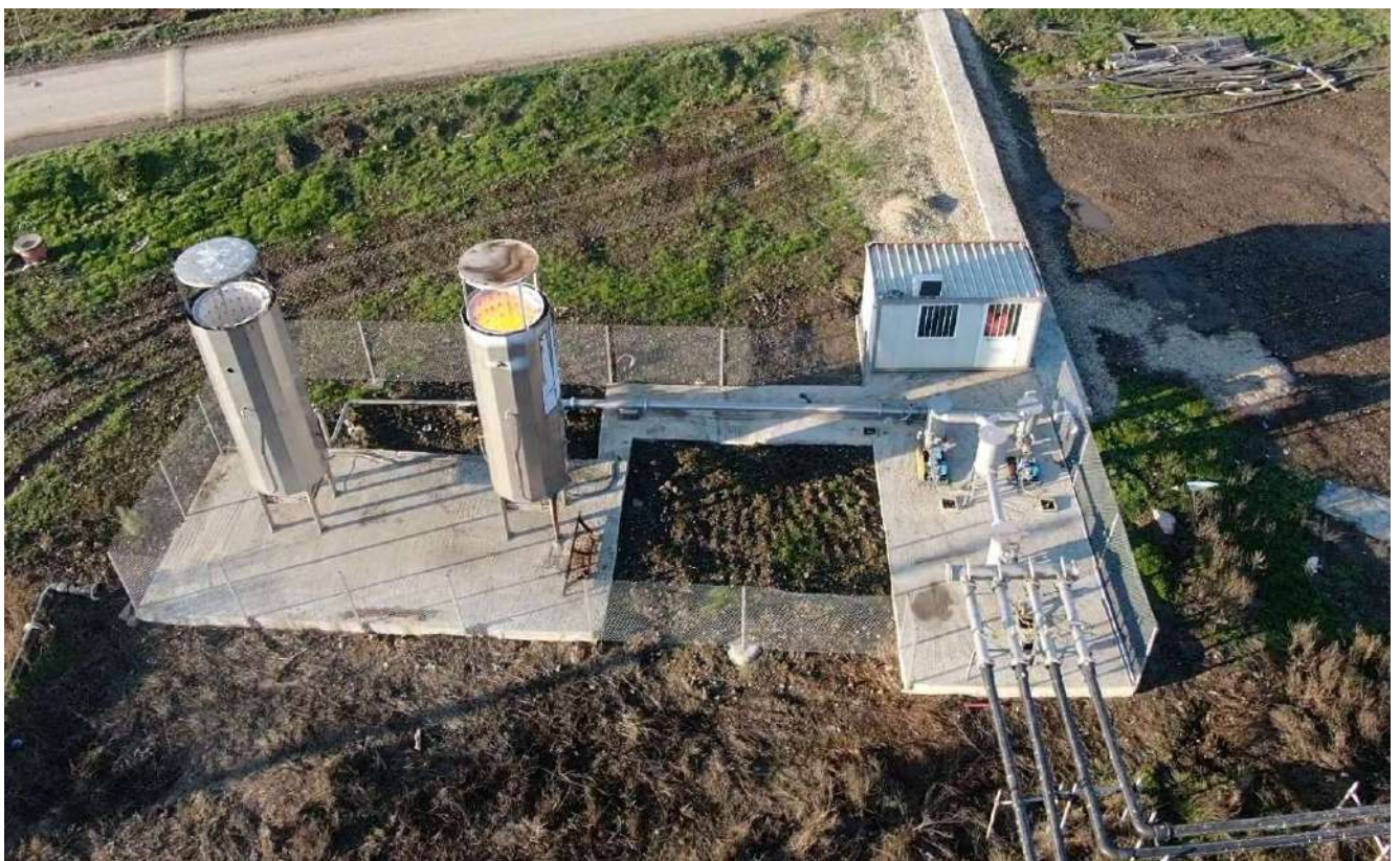
Figura nr. 1.4 Instalație de ardere controlată a gazului de depozit
