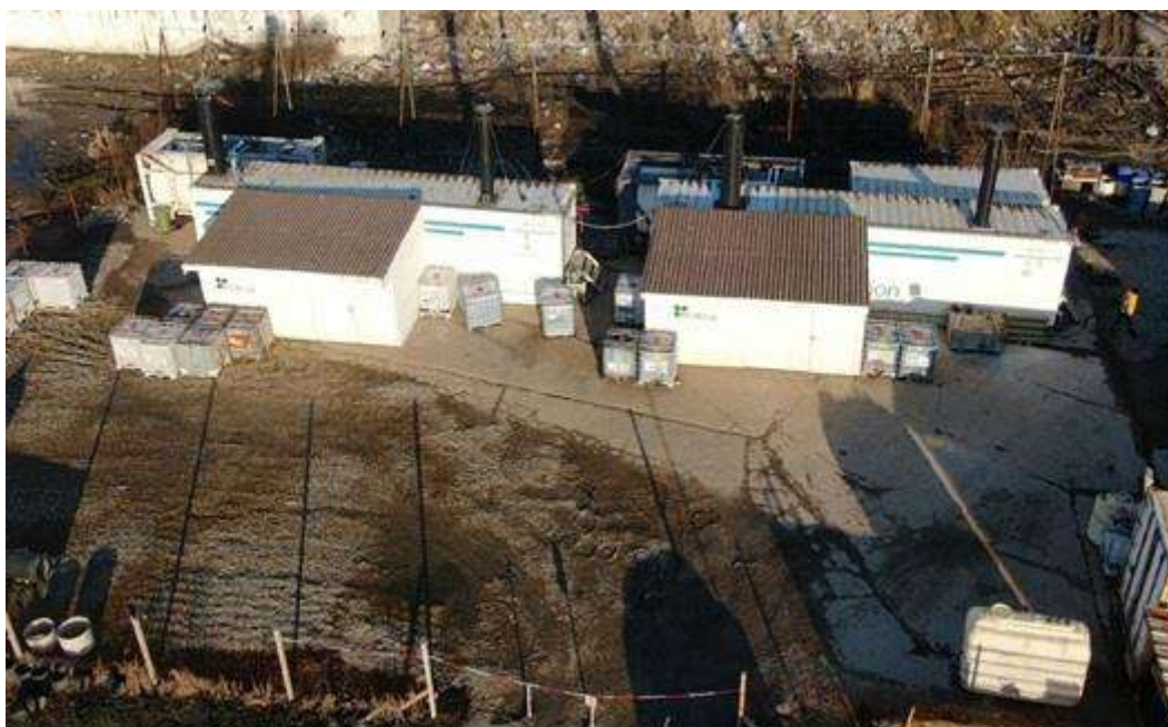
Figura nr. 4-1 Stația de epurare levigat
