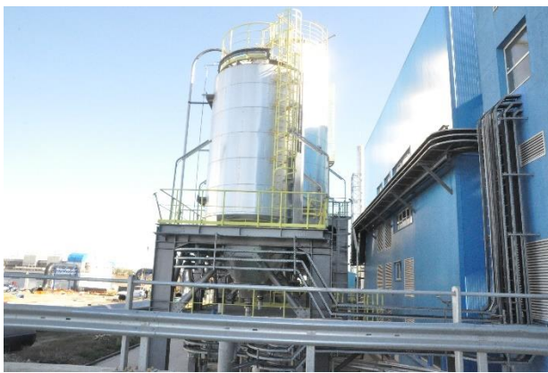
Zona de depozitare a cenușii în silozuri
